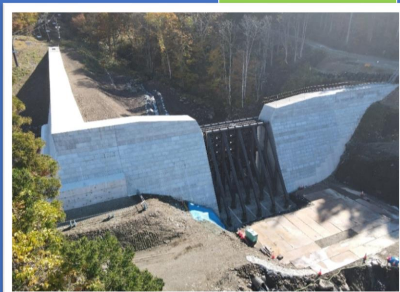
水沢第2砂防堰堤
