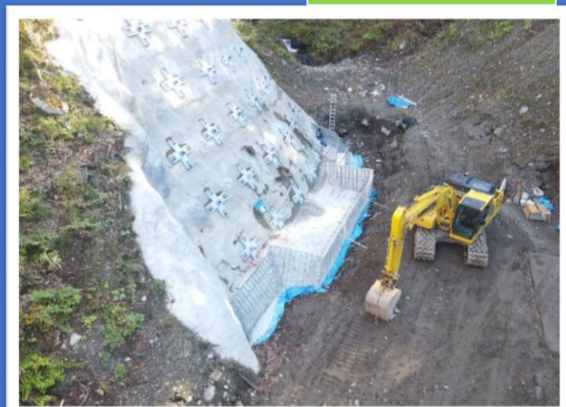
水沢第3砂防堰堤
