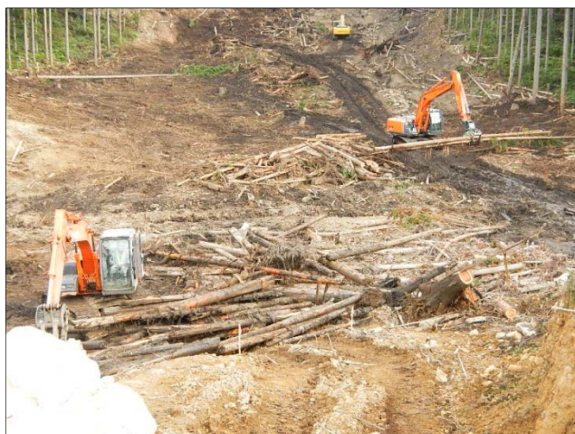
斜面に残る倒木の処理状況
