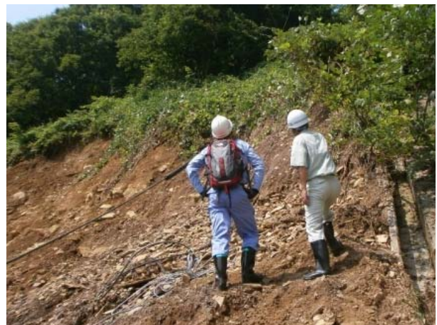
崩壊斜面頂部の状況確認
