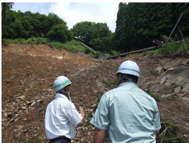
崩壊斜面上部の状況確認
