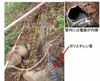
写真Ⅲ-④ 滑落崖上部斜面中に認められる、電線保護管と地山の露出。黄色破線が崩壊前に埋設されていたと考えられるくぼみ。崩壊地で引っ張られ曲部で跳ね上がったと考えられる。
