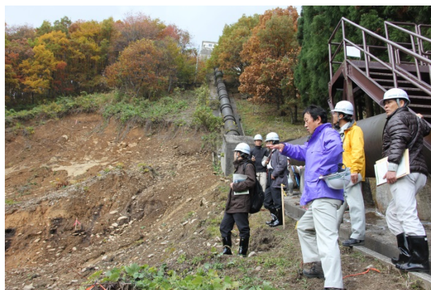
崩壊斜面頂部の状況確認
