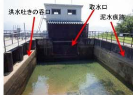
写真Ⅲ-⑤ 調節池の泥水痕跡は、洪水吐きの呑口まで上昇したが、越流は確認できない。
