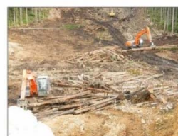
斜面に残る倒木の処理状況
