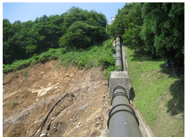
崩壊斜面と先達発電所水圧鉄管
