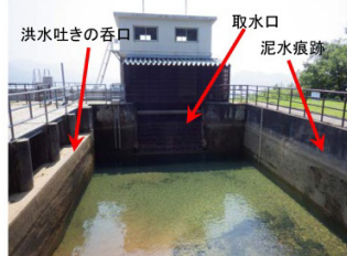
写真Ⅲ-⑤ 調節池の泥水痕跡は、洪水吐きの呑口まで上昇したが、越流は確認できない。
