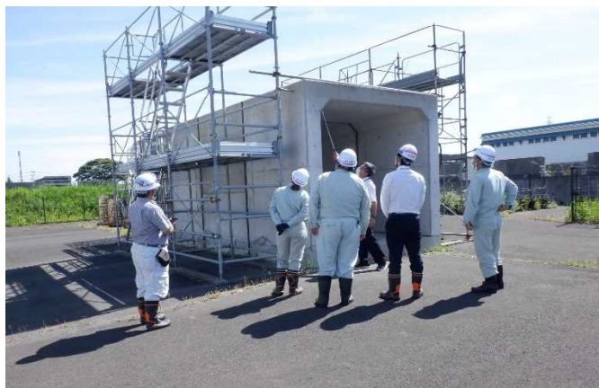
函渠工の不適切箇所の確認
