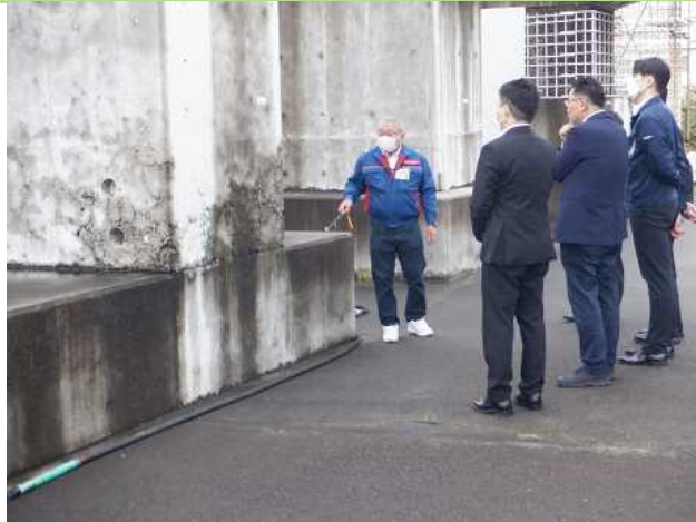
不適切施工について
