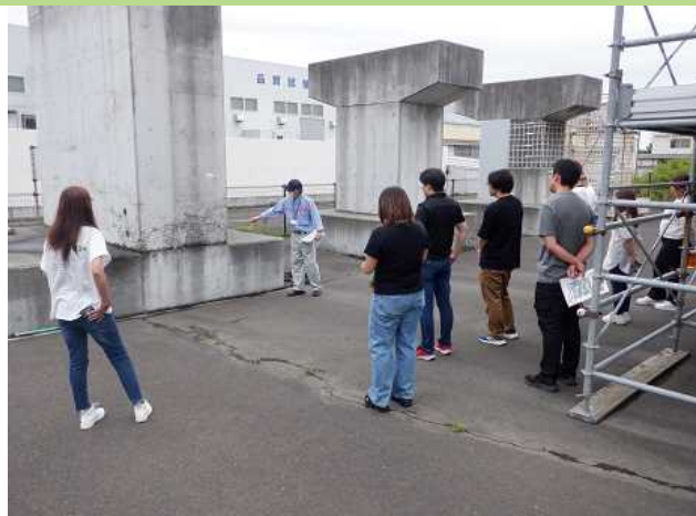
不適切施工について
