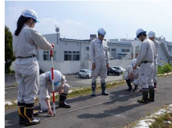
堤防の亀裂の計測
