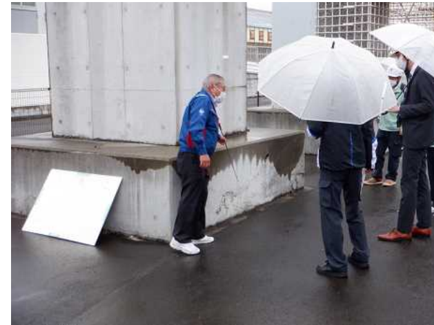
不適切施工について
