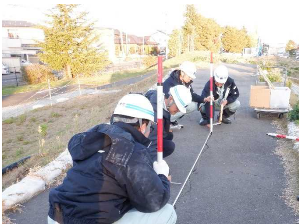
堤防の亀裂の計測
