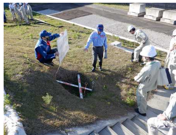
堤防の陥没の計測について
