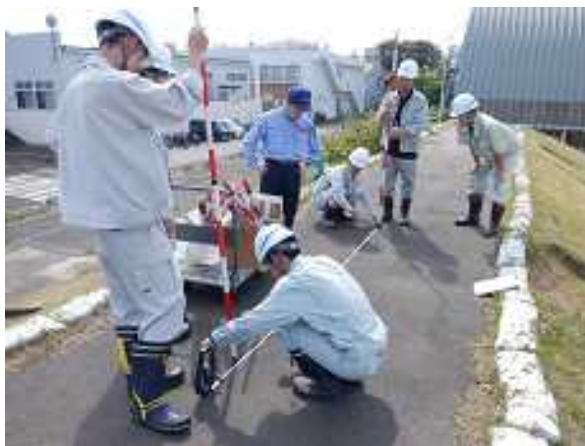
堤防の亀裂の計測
