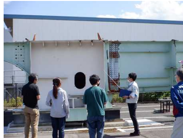
損傷箱桁について
