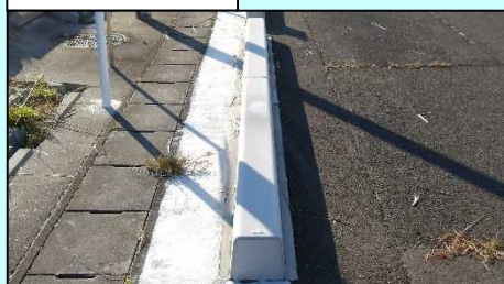
防草ブロック
