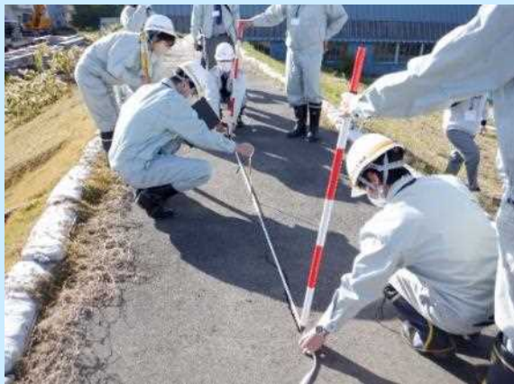
堤防天端亀裂の計測
