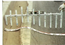
施工前の帯状不陸状況(不陸高7cm)
