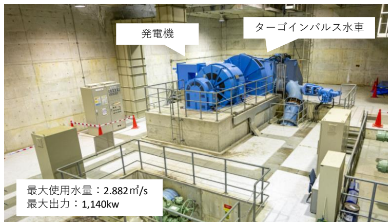
管理用発電所内
