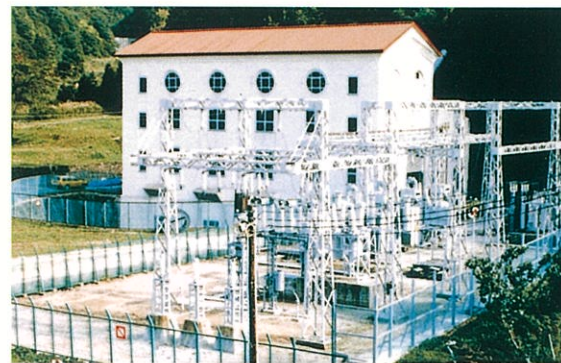
立谷沢第1発電所
