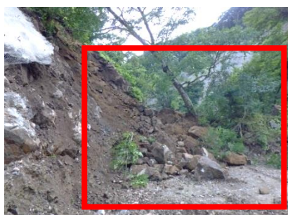
資料11 法面崩壊
