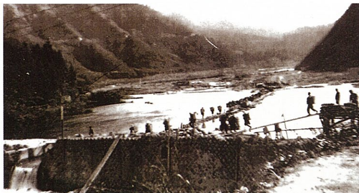
セメント以外の資材は現地発生材、ほとんど人力で行われたダム工事
