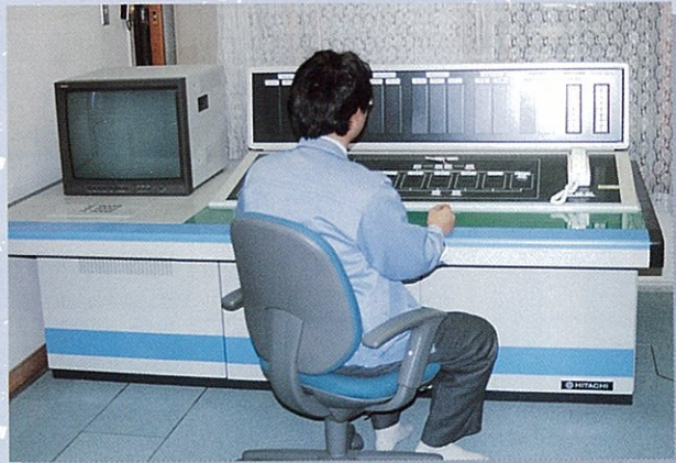
ゲート設備遠隔操作室(真室川町役場1F)
