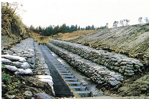
コルゲートフリユーム水路
