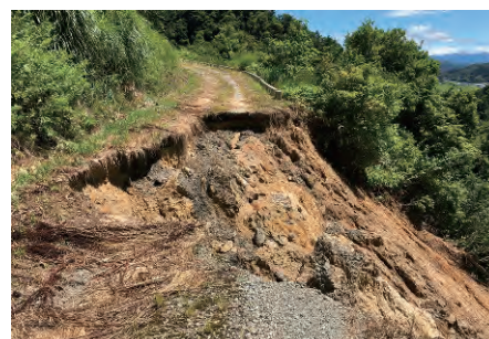
写真 27-5 崩れた道路(林道熊高桜峠線)
