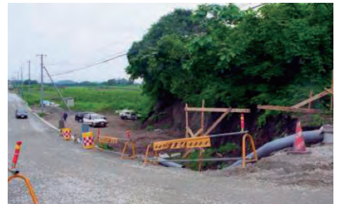
写真 24-2 平成 8 年の湯の台の地すべりで陥没し、きれつが入った国道 458 号 （東北森林管理局技術検討会資料より）
