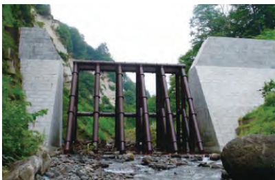
写真 35-3 赤松第7砂防堰堤(透過型)
