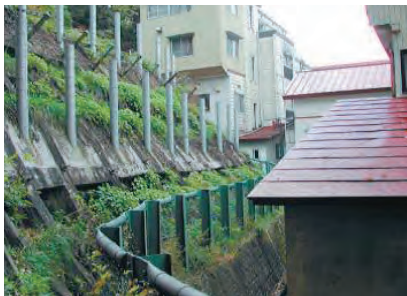
写真 37-1 肘折温泉街の建物の裏側に整備された、がけ崩れ災害を防ぐ施設 建物のすぐ後ろの緑色の柵が、がけ崩れの土砂を受け止める施設。斜面に立つ柱は、雪崩を防ぐ施設。
