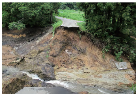
写真 27-1 大蔵村大字清水字水ヶ沢地内 ため池が決壊し、村道水ヶ沢線の道路が崩落
