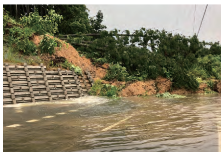
写真 27-3 県道大石田畑線比良稲沢地内の土砂崩れ 電柱もなぞ倒された。
