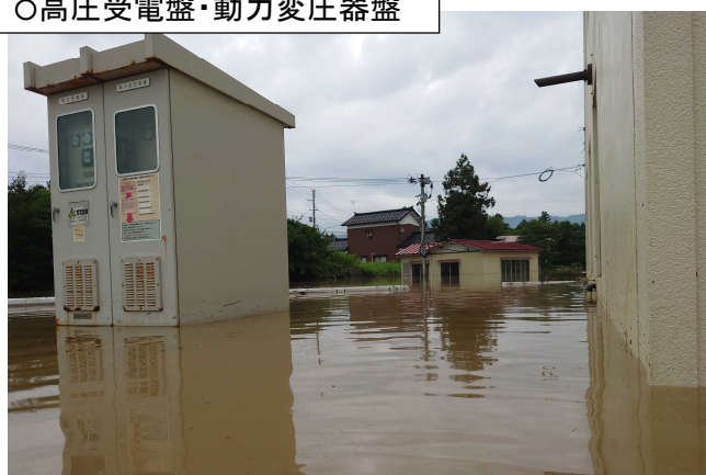
○高圧受電盤・動力変圧器盤
