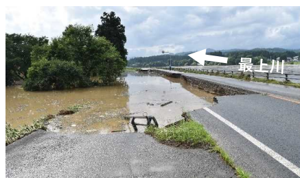
【国】最上川44.3k付近(堤防欠損状況)
