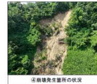
④崩壊発生箇所の様相
