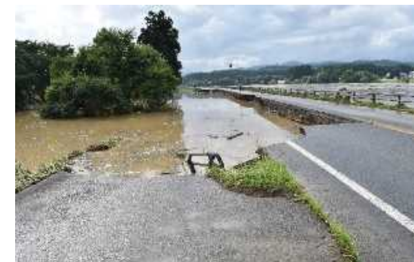
《最上川45.3k付近の浸水被害状況》
