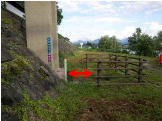
転落防止柵の設置延長が不足
