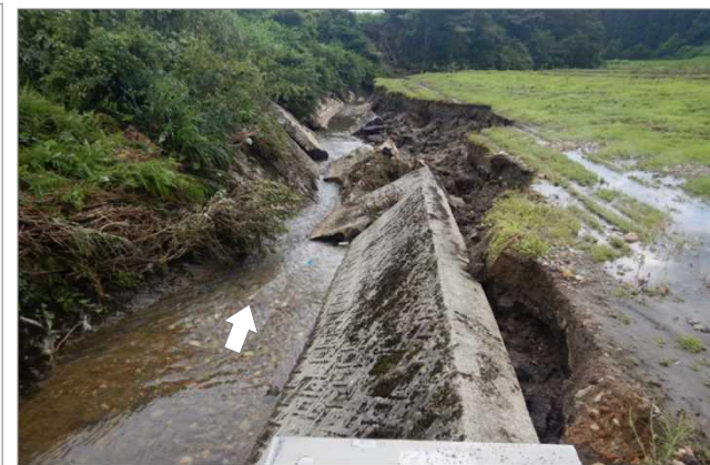
護岸損壊 - 金堀沢川（新庄市升形）
