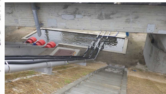
排水ポンプ3台を常設
