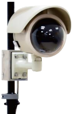
設置した簡易型河川監視カメラ
