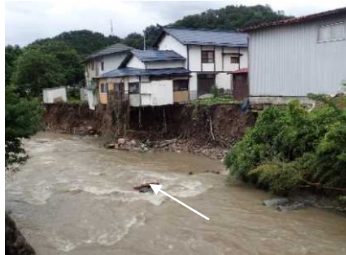
被災状況(R2.7.29)
