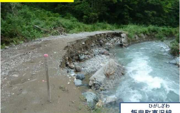
林道擁壁の損壊
