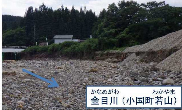
河岸崩壊(50m)及び除雪基地の浸水
