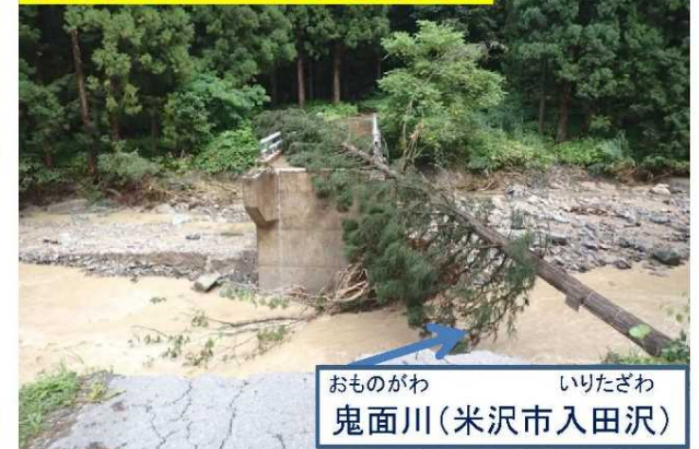
護岸損壊(120m)、市道橋流失
