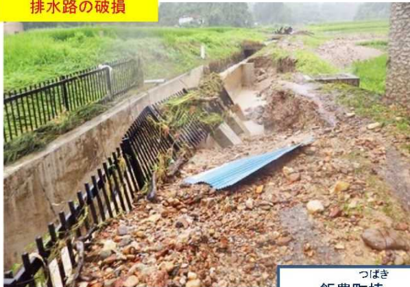
排水路の破損
