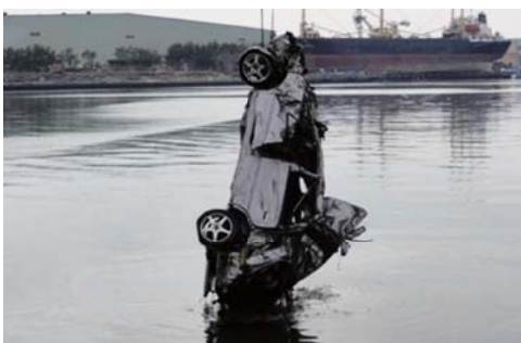
航路啓開状況・仙台塩釜港 (沈んだクルマの除去)
