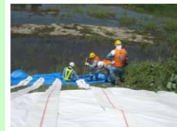
建物や道路などが冠水した際に、排水ポンプ車で排水作業ができるよう訓練しています。
