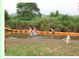
水質事故が発生した場合、オイルフェンスなどを設置し、油などの拡散を防止します。
