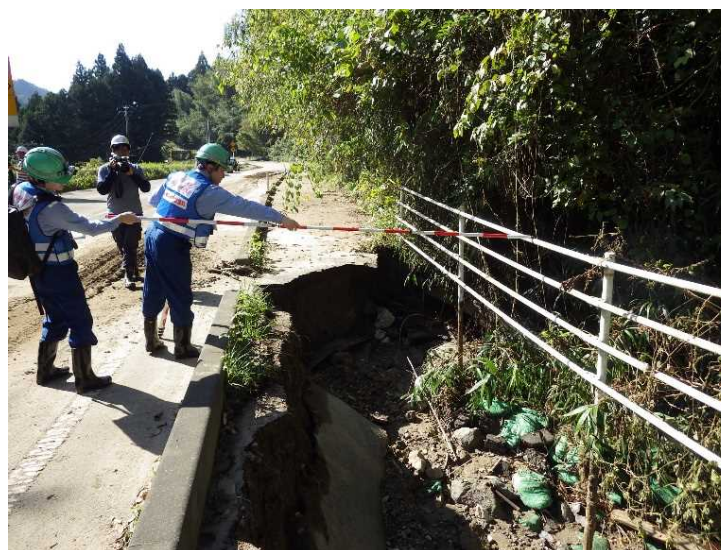
丸森町被災状況調査（10月17日撮影）
