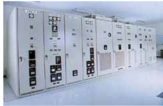
七ヶ宿ダム 受変電設備
