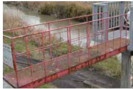
管理橋塗装の劣化(笹原川第6樋管)
