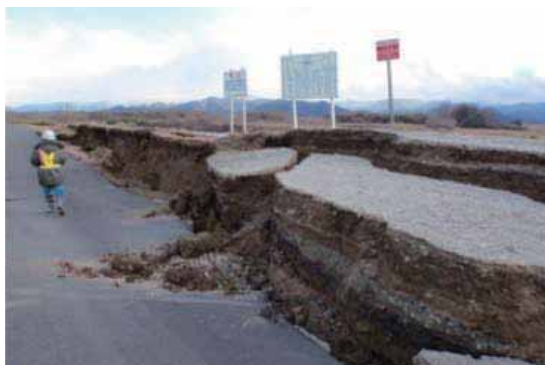
地震による堤防沈下と天端の崩壊 (阿武隈川右岸31.0k付近 (角田市枝野地先))
