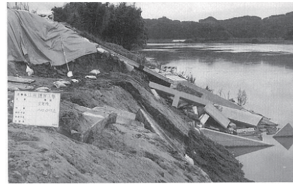
河岸崩壊の状況 昭和 61 年 8 月洪水 宮城県区間 20.0km 付近
