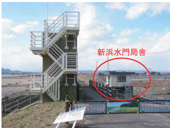
新浜水門（被災後）
