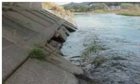
支川荒川 信夫橋護岸の崩壊の状況
