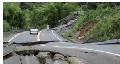
被災状況調査
