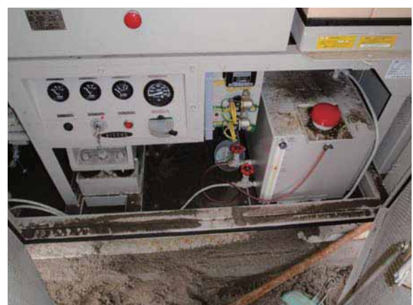
発電機盤の被災状況
