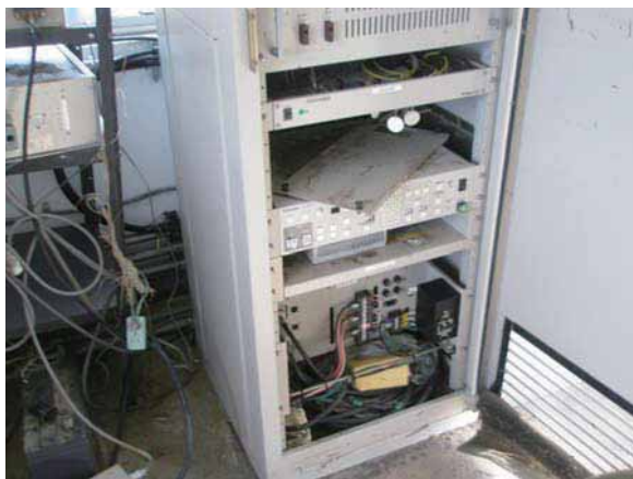
CCTV機側装置の被災状況
