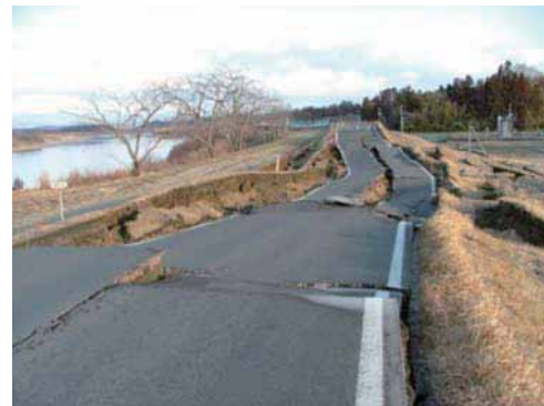
地震による堤防沈下と天端の陥没 (阿武隈川右岸22.0k付近 (角田市坂津田地先))
