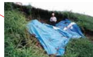
昭和61年洪水 法崩れ被害の状況
