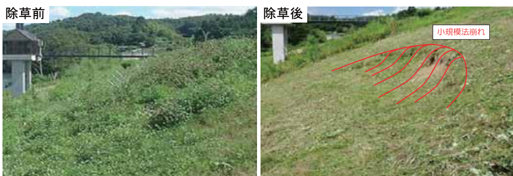
堤防除草により早期に発見された法崩れ
