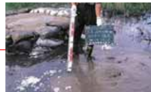
昭和61年洪水 漏水被害の状況
