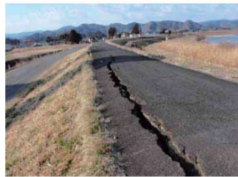
地震による堤防縦断亀裂 (阿武隈川右岸33.0k付近 (丸森町小齊地先))
