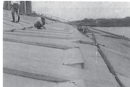
S53年宮城県沖地震による護岸の被災状況 【宮城県岩沼市】
