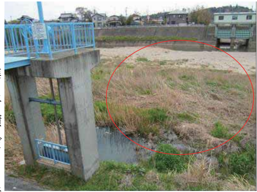
樋門の吐口に堆積した土砂
