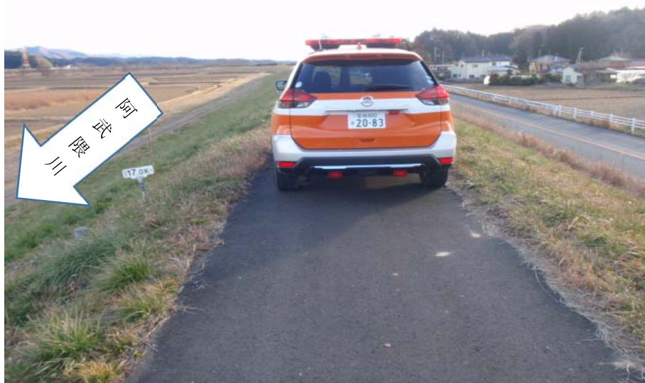
図 2 - 2 堤防天端の幅狭
