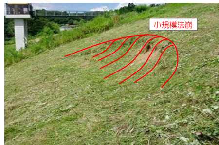
写真5-4 法崩れの状況
