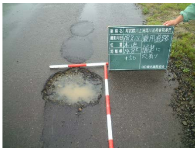
写真5-3 堤防天端のポットホール
