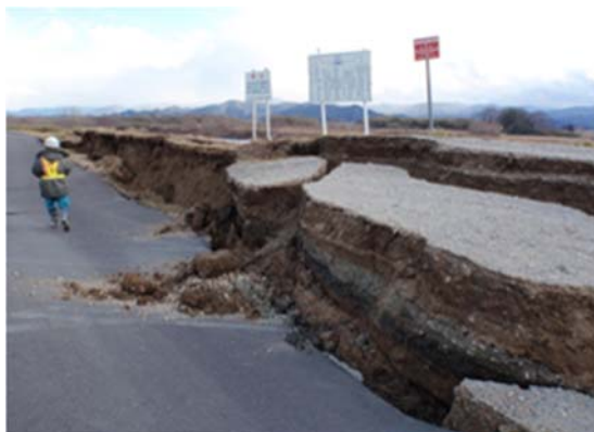
堤防の被災状況（阿武隈川右岸 枝野地区）
