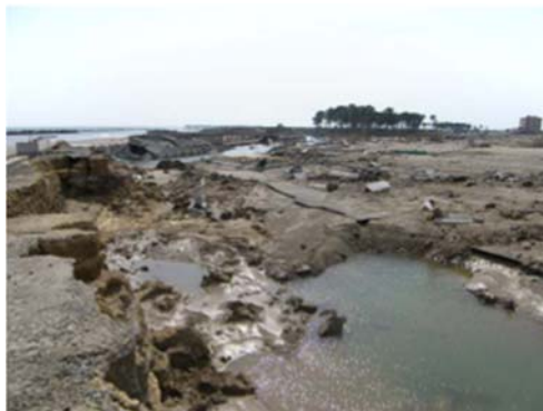
堤防の被災状況（阿武隈川右岸 荒浜地区）
