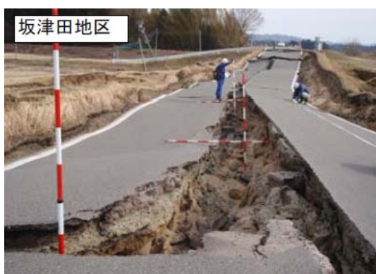
堤防被災状況（阿武隈川右岸 坂津田地区）
