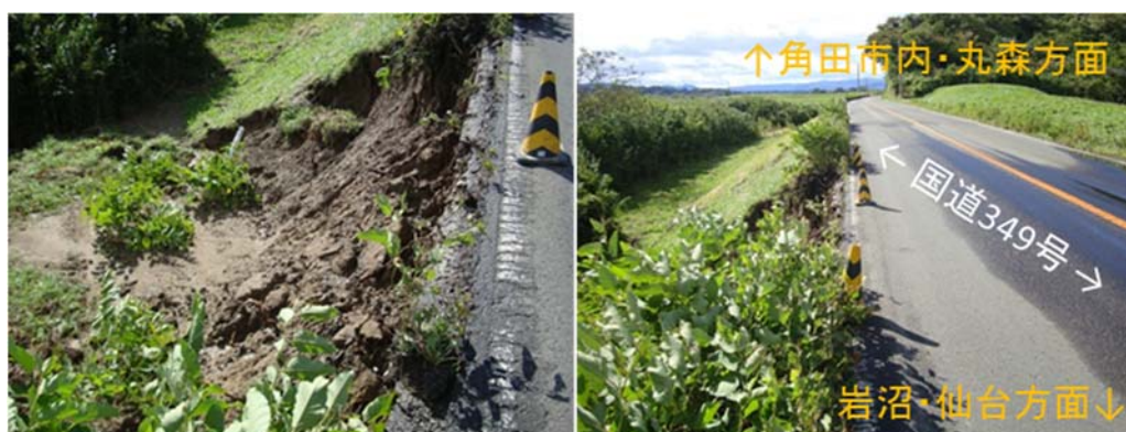
図 2 - 3 兼用堤区間の平成 26 年 10 月 14 日 (火) の被災状況
