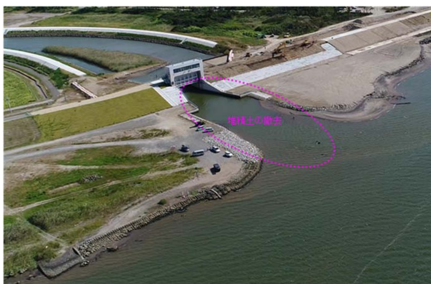
写真 2 - 1 河口部の堆砂状況
