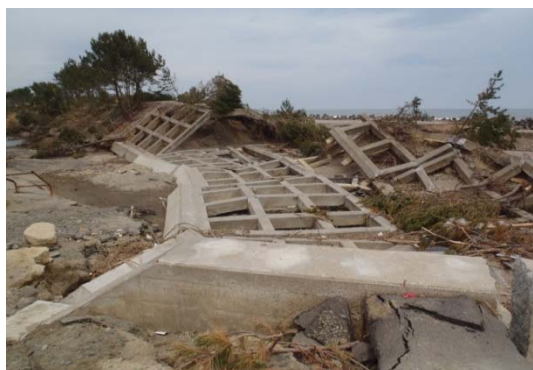
護岸の被災状況（阿武隈川右岸 河口付近）
