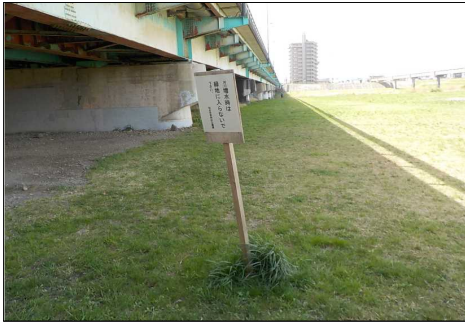
看板支柱の傾き
