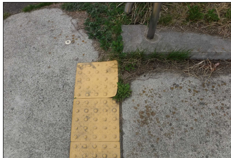
点字シートのめくれ
