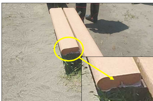
ベンチの破損
