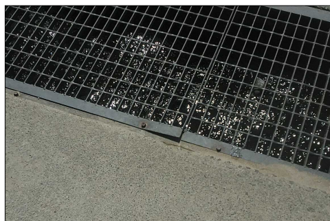
グレーチング変形
