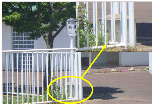
看板不安定（ぐらつき）
