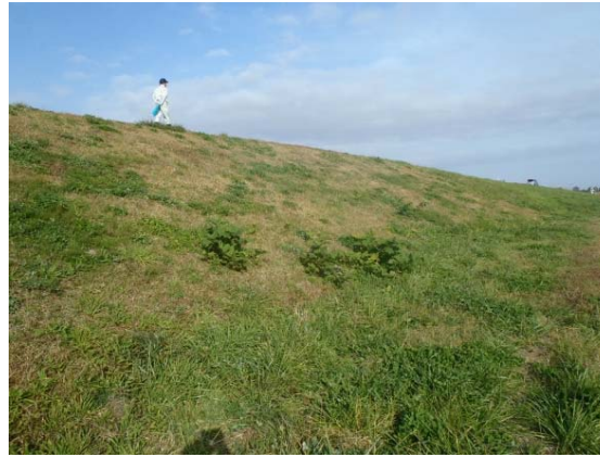
堤防の表面が見え、堤防の異常の有無が確認できる状態
