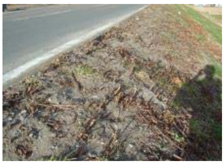
堤防法面の裸地化
