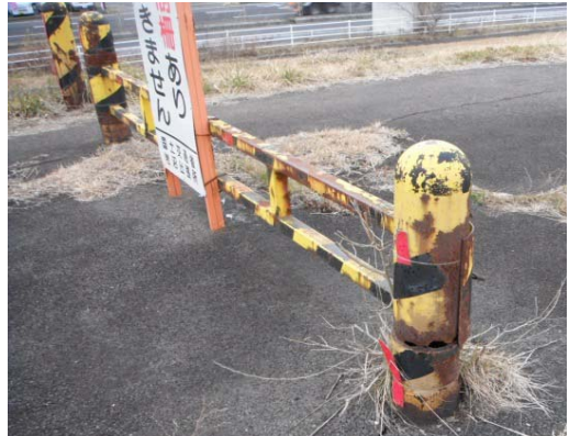
規制柵の損傷
