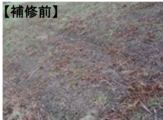
堤防法面の損傷状況（裸地化）
