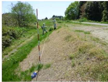
堤防法面の裸地化
