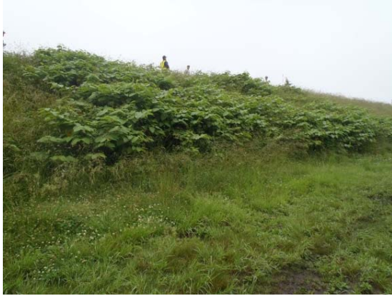
植生の繁茂により堤防の表面が見えない状態
