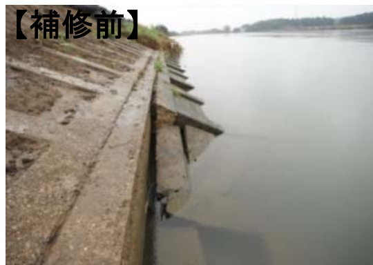
護岸損傷状況（護岸の沈下）
