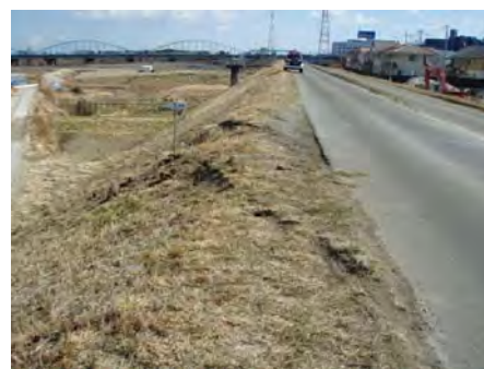
車両による堤防損傷
