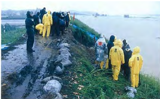
S61.8洪水 藤塚地区法崩れの状況
