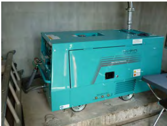
発電機設置状況(地震前)
