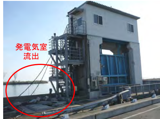
閉上水門(被災後)
