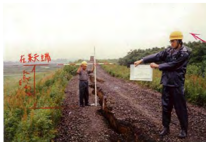
堤防の亀裂・沈下
