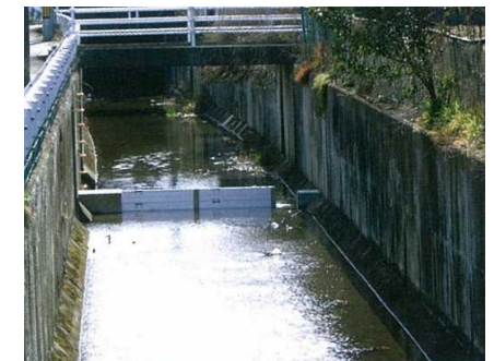
逆流防止施設
