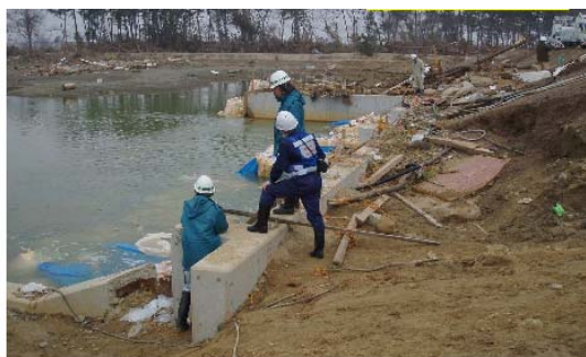
TEC-FORCE の派遣状況 (H23.4.11 井土浦川付近)
