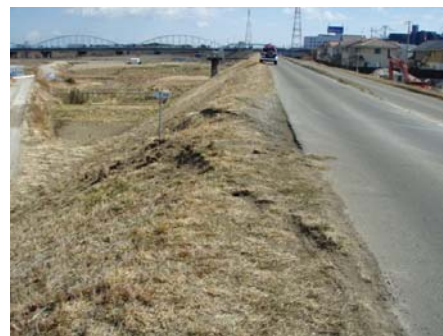
車両による堤防損傷
