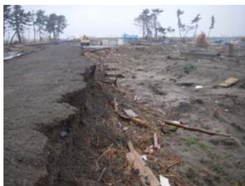
被災状況 (河口から左岸0.0k付近、 仙台市若林区藤塚地先)
