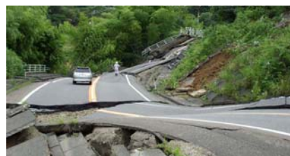
被災状況調査
