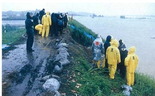
S61.8洪水 藤塚地区法崩れの状況
