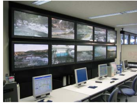
ダム放流設備制御装置
