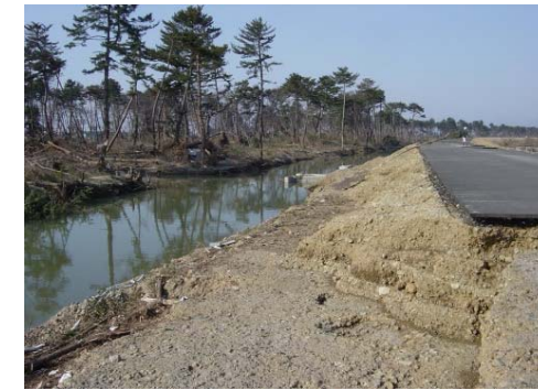
名取川左岸0.0k付近 仙台市若林区藤塚地先 津波により堤防決壊
