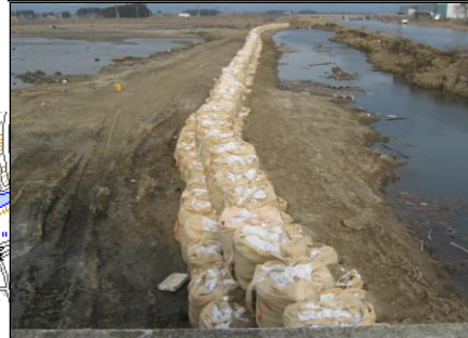
大型のうり急復旧
