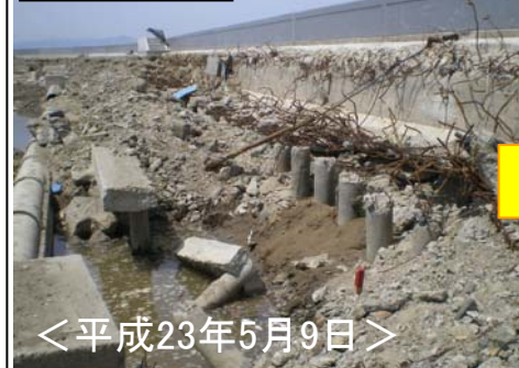
堤防被災状況
