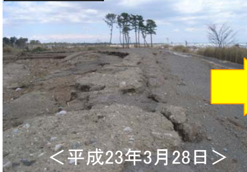
堤防被災状況
