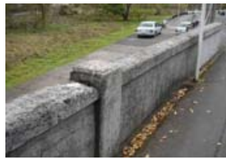
かだん 花壇自動車学校前の堤防の損傷・劣化状況
