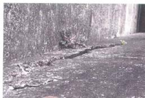
門柱と翼壁接合部の剥離
