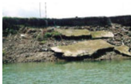
河岸崩壊の状況
