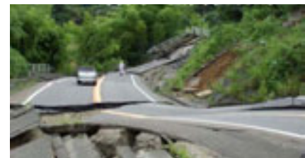
被災状況調査
