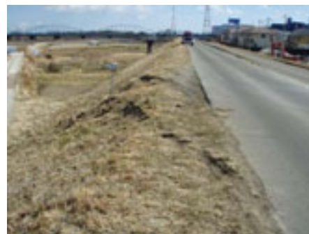
車両による堤防損傷
