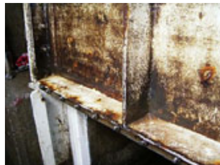
ゲート塗装の劣化状況（山口排水樋管）
