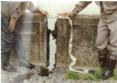
関上特殊堤接合部の開口
