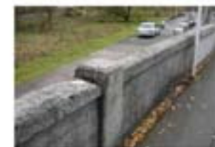
花壇自動車学校前の堤防の損傷・劣化状況
