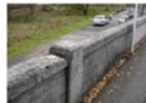
花壇自動車学校前の堤防の損傷・劣化状況
