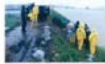
図 3.1.2 高龍川に広がる堤防の被害
