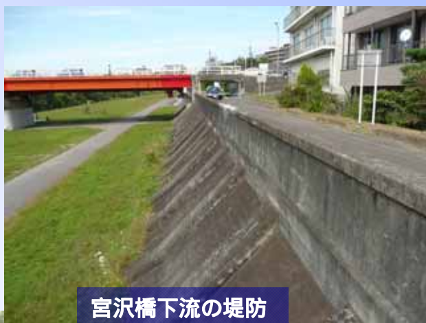
堤防・護岸の損傷状況(宮沢橋)
