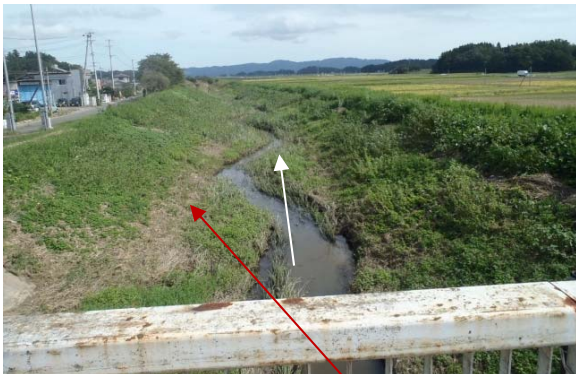
堆積土砂（流下能力の阻害）
